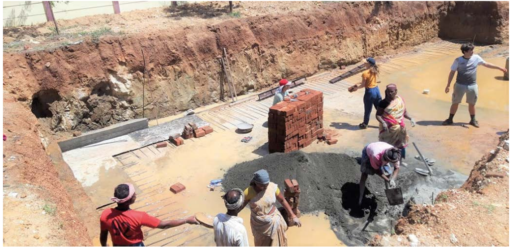
Jeder Tropfen Wasser ist kostbar! Mit der Errichtung von Regenwassertanks kann das Dachflächenwasser der Schulgebäude gesammelt werden.
